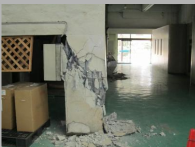
柱せん断破壊
